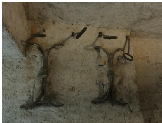
Murbindere og hendler for betjening av fyringsanlegg
