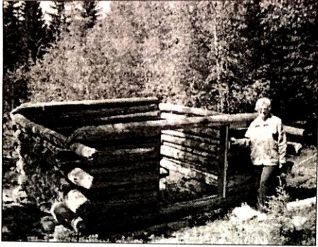
Det mangler bare tak på den nye høyløa som har blitt satt på Eiktunet. Om et par uker vil den stå ferdig, håper konservator Anne-Lise Svendsen.
