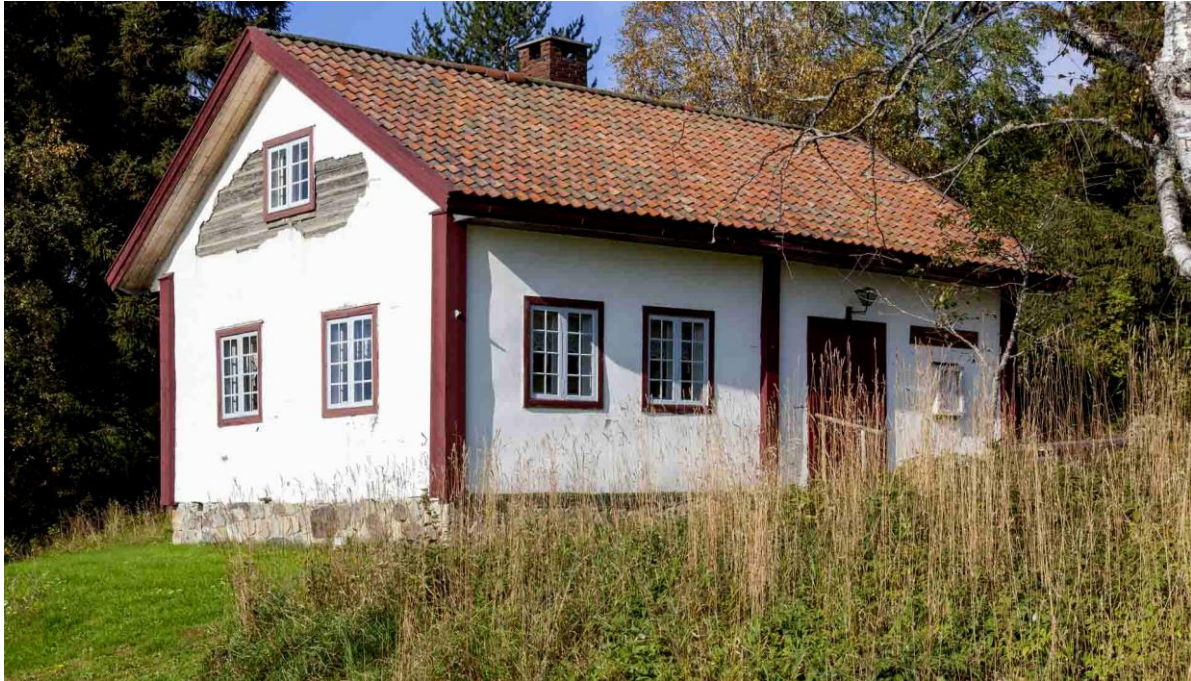
Vårnesbygningen. Det er tydelig at det kan være vanskelig å få rappingen til å sitte på værutsatte vegger. Foto: Audbjørn Rønning
